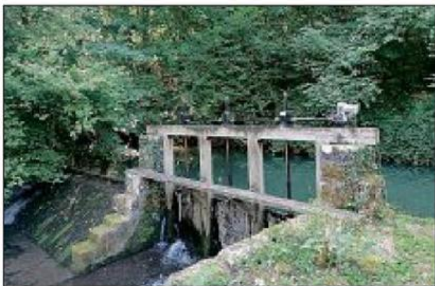
L'ouverture des vannes pose notamment problème.
