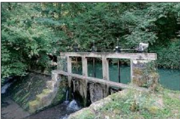
L'ouverture des vannes pose notamment problème.
