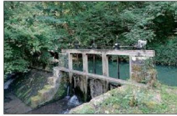
L'ouverture des vannes pose notamment problème.
